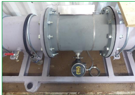
Figure 4: Le densimètre Rhosonics à l'emplacement d'essai
